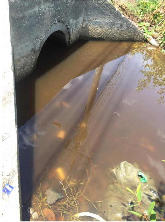
Ilustración 9. Los manjones de la carretera se encuentran obstruidos por lo cual se observa represamiento de aguas y sólidos que afectan el intercambio hídrico.
