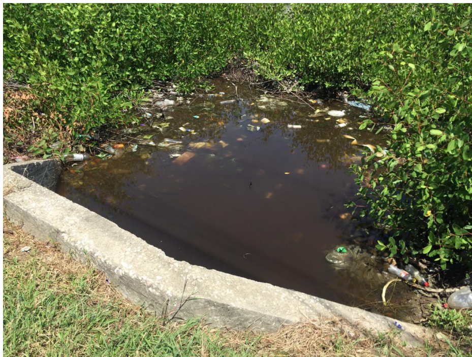
Ilustración 11. Daño integral progresivo por represamiento de aguas negras.
