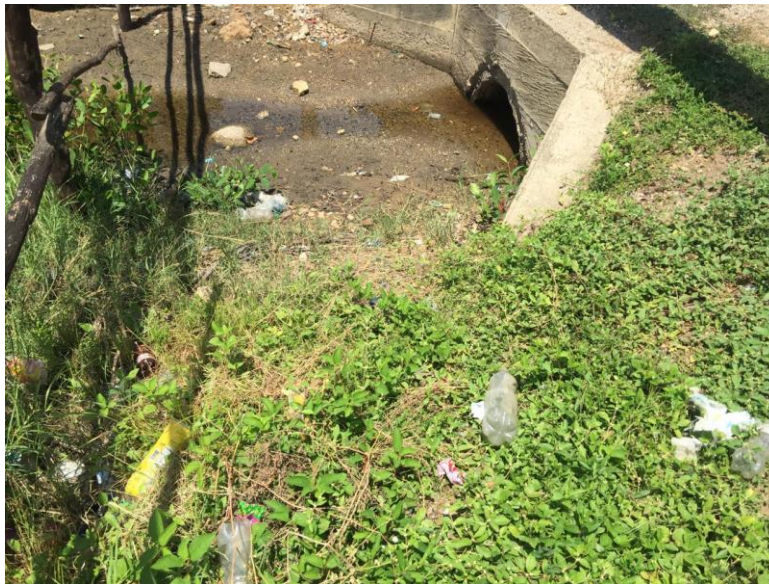
Ilustración 10. La acumulación de basuras es evidente.
