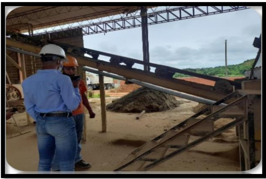
Figura 1. Proceso de Molienda.
